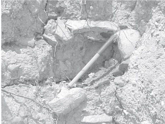
Εικόνα 3. Τμήμα υδροσωλήνας, στο άκρο του μονοπατιού
